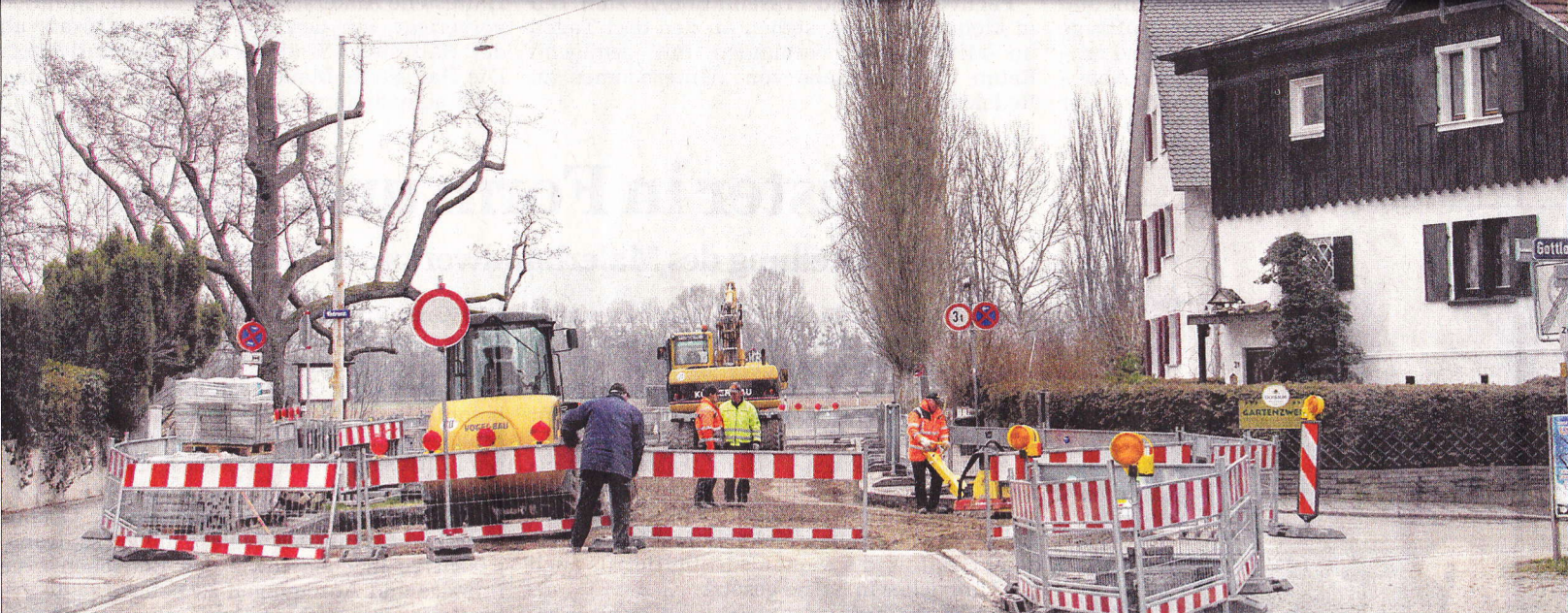
HIER GEHT'S NICHT WEITER: Die Baustelle am Scheibenhardter Weg im Weiherfeld ist immer noch da. Derzeit wird am letzten Stück zwischen Wehrastraße und Gottlob-Schreiber-Weg gearbeitet. Ursprünglich sollten die Arbeiten vor Weihnachten beendet sein. Nun wird es wohl Ende Februar werden. Foto: jodo
